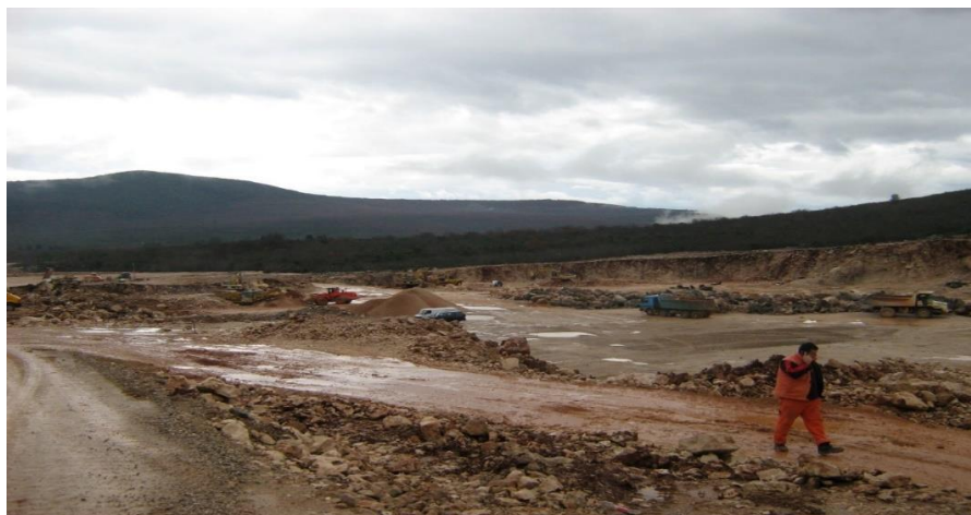
Slika br. 5: Početak izgradnje Međunarodnog graničnog prelaza Bijača 2013-ta godina, arhiva JGP Doljani 39
