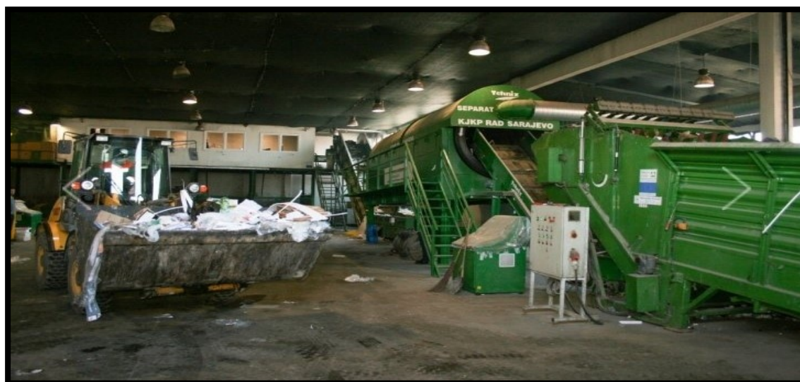
Slika 2: Sortirnica otpada na deponiji Smiljevići ( Arhiv KJKP Rad).
